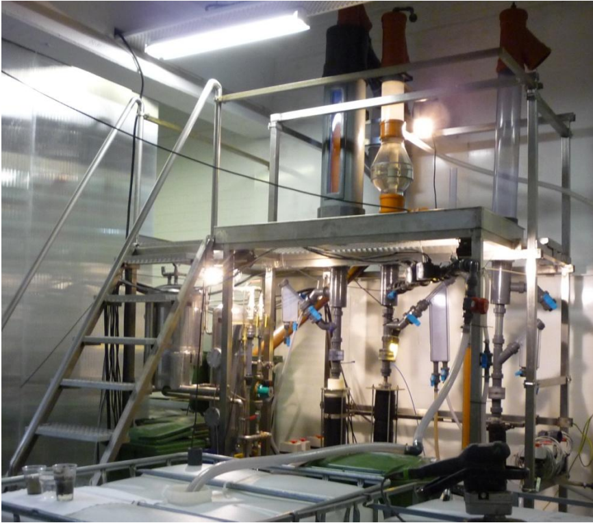
Kuva 8: MUST koelaitos jota käytettiin Talvivaaran loppuneutraloinnin syötteen ja sen ylitteen puhdistukseen. Reaktorikennot keskellä alhaalla ja erotustornit niiden yläpuolella
